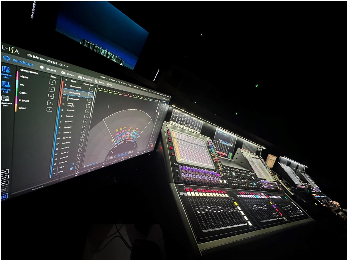
Configuration redondante pour audio live : régie avec deux consoles DiGiCo Quantum 5 en miroir, pour l'opéra The Canal Ballad à l'occasion de l'inauguration du Centre des arts de la scène de Beijing en décembre 2023. (Crédit photo : Racpro)
